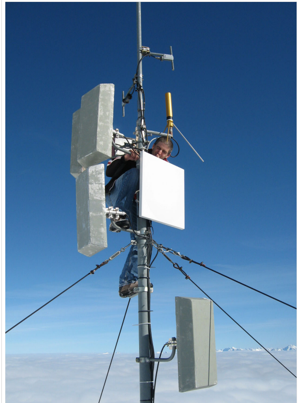
Antennenanlage OE7XGR, OE7FMI im Oktober 2009
