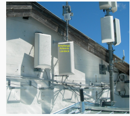
Empfangsantenne Richtung Landeck
