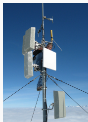
Antennenanlage OE7XGR, OE7FMI im Oktober 2009
