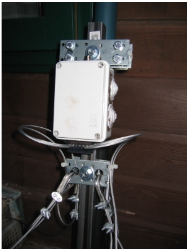
Transformator im geschlossenen Gehäuse
