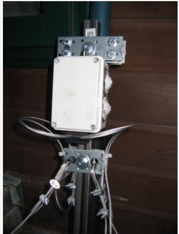
Transformator im geschlossenen Gehäuse
