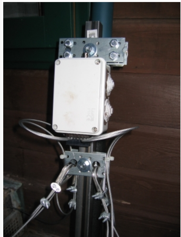
Transformator im geschlossenen Gehäuse
