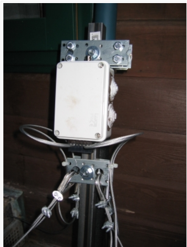
Transformator im geschlossenen Gehäuse
