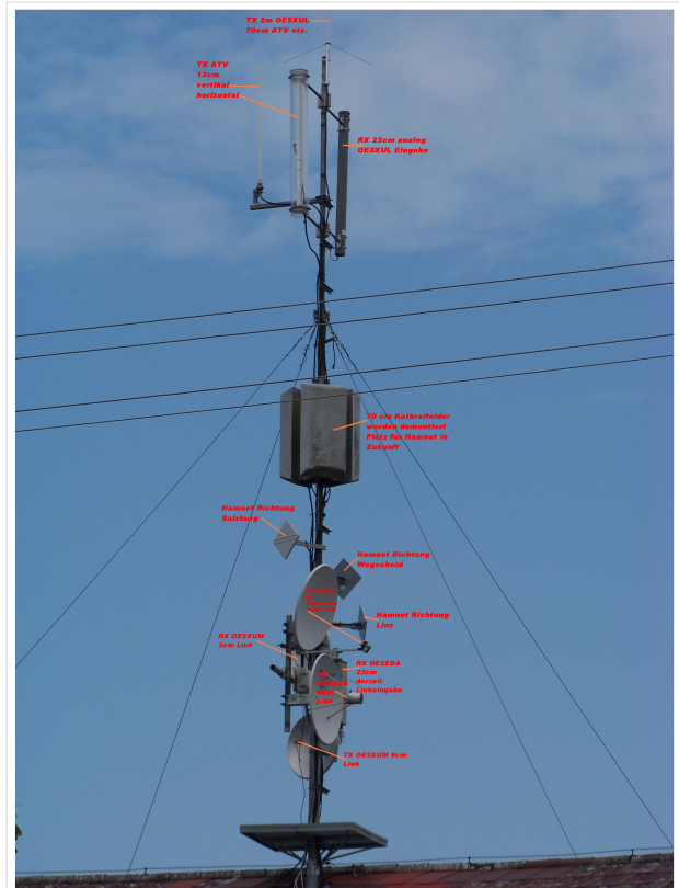
Bild der Antennenanlage
