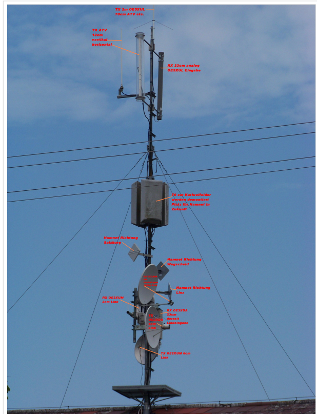
Bild der Antennenanlage
