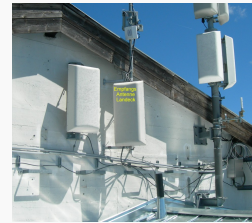
Empfangsantenne Richtung Landeck
