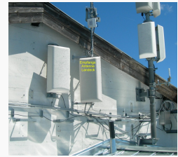
Empfangsantenne Richtung Landeck
