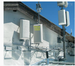
Empfangsantenne Richtung Landeck
