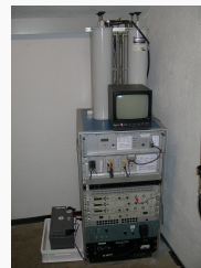
Geräteschrank ATV, darunter OE7XTR 145,775
