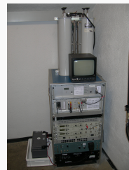
Geräteschrank ATV, darunter OE7XTR 145,775
