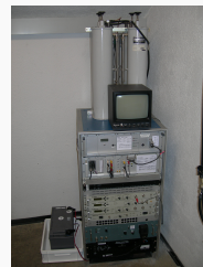
Geräteschrank ATV, darunter OE7XTR 145,775
