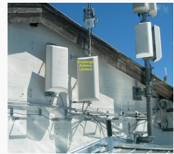
Empfangsantenne Richtung Landeck
