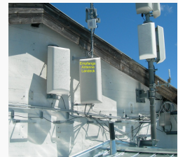
Empfangsantenne Richtung Landeck
