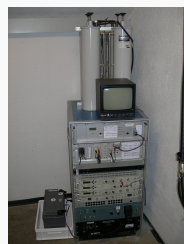
Geräteschrank ATV, darunter OE7XTR 145,775
