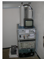
Geräteschrank ATV, darunter OE7XTR 145,775
