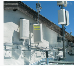
Empfangsantenne Richtung Landeck
