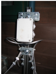
OE1IFM Transformator im geschlossenen Gehäuse
