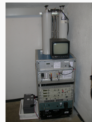
Geräteschrank ATV, darunter OE7XTR 145,775
