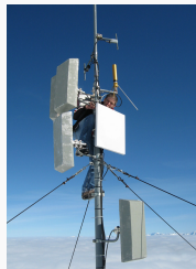
Antennenanlage OE7XGR, OE7FMI im Oktober 2009
