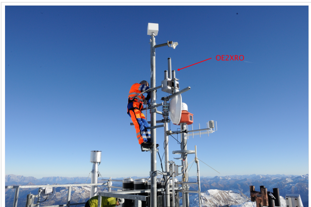
Blick auf die Bake OE2XRO mit 3 Antennen
